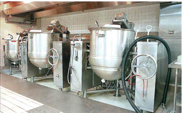
写真1-2 UDS-スチームケトルラインとガス・カップラー接続具
