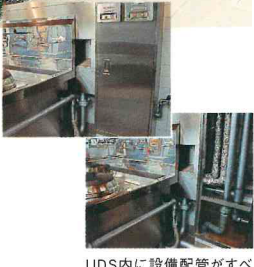
UDS内に設備配管がすべて組み込まれている
